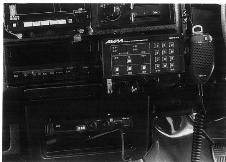
図-14 52形無線機の取付状態
